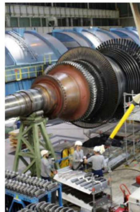
Rotor en salle des machines
